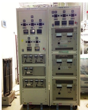
図2-4 試験用電源の外観
