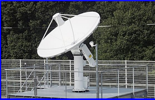
AES衛星地上局アンテナ
