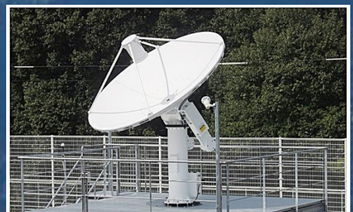
AES衛星地上局アンテナ
